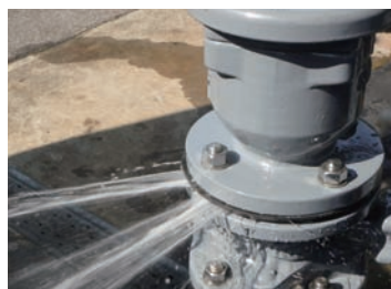
フランジ部からの漏水事故例
