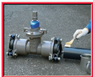
①管挿し口及びバルブ受口に、メーカー指定の水道用滑剤を塗布します。
